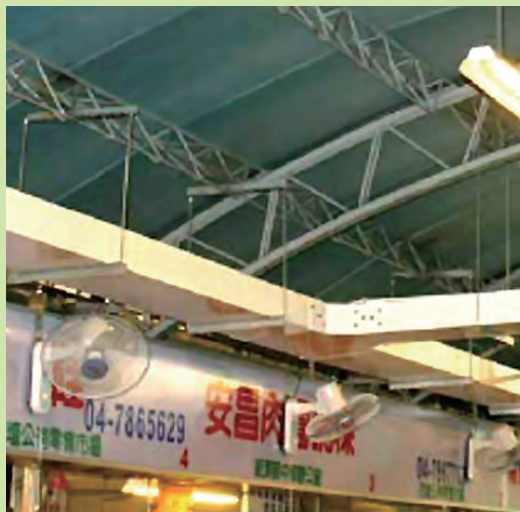
鋁材包覆型集線槽，槽體封閉，不易有電線走火之虞。
