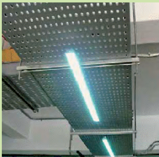
格柵式烤漆集線槽，結合照明設備，整齊劃一。
