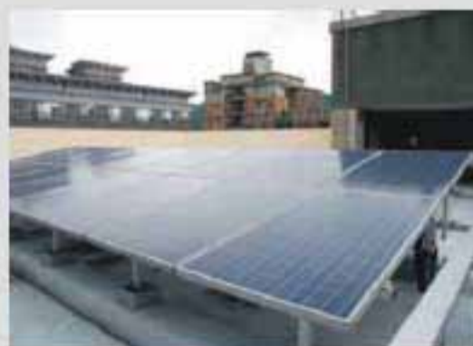
● 綠色市集 新北市泰山市場使用太陽能板裝置
