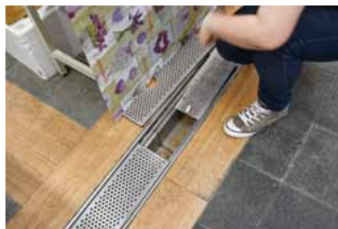
水溝洩水坡度依專業丈量設計並定期清洗。
