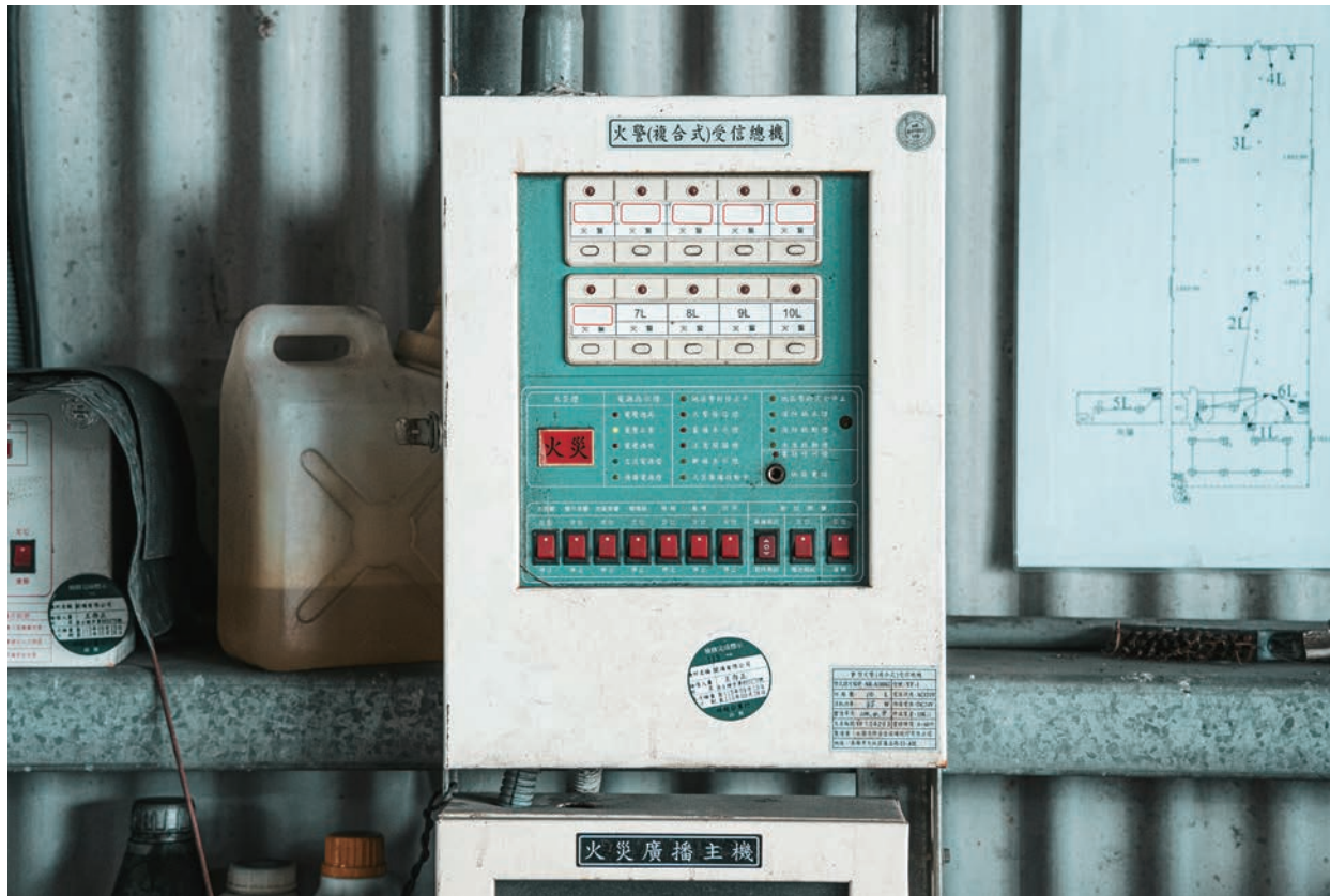
閤順建置功能完善的消防設備，工廠朝向合法第一步。
