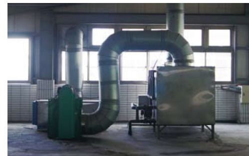
●二樓設有排油煙設備
